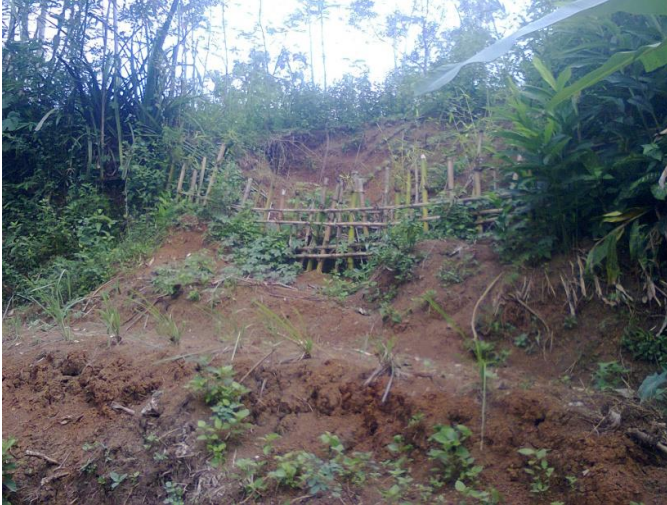
Gambar: Foto patok penyangga longsorlahan
